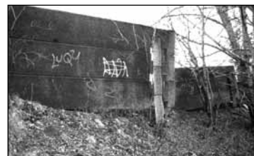
På delar av strekninga forbi Skedsmovollen er det støyskjermar, som denne fra 80-talet i dårleg stand.
